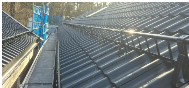
Ferdig montert løsning
